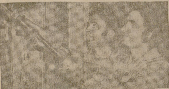
Електромониторите, Те Христов и Христо Гецов извършват оперативна превключаване на електроуредбата за собствени нужди на цеха.
